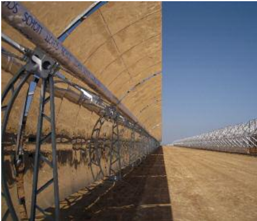
Detalle de cilindros parabólicos en una planta solar termoeléctrica.
