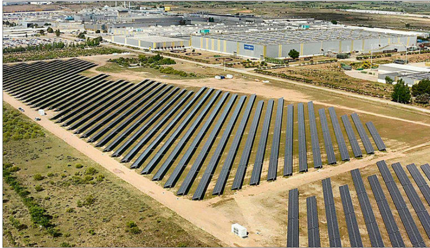
Imagen aérea del nuevo parque fotovoltaico en la planta de Stellantis en Zaragoza. EL MUNDO
