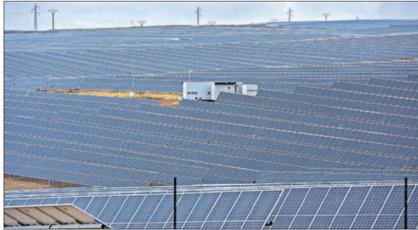
Planta fotovoltaica de Iberdrola en Ceclavín (Cáceres). / GETTY
