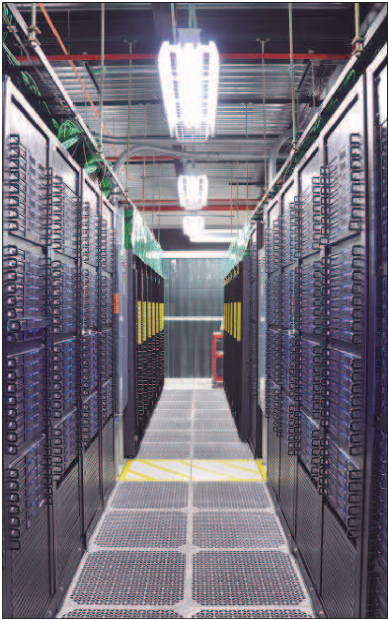
Interior de un 'data center'. ISTOCK
